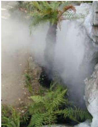
アミューズメント施設 霧演出 大阪府 ■FRP造作の岩組み部にノズルを仕込んでタイマーによる霧の演出。
